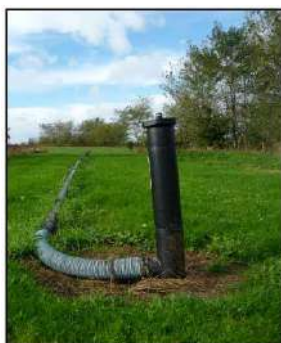
Figure 2 : Photo d'un puit de captage
