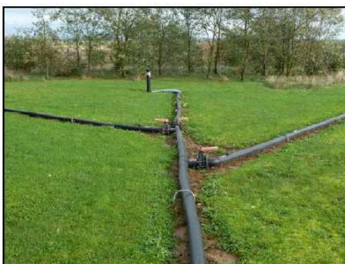
Figure 3 : Photo d'un collecteur
