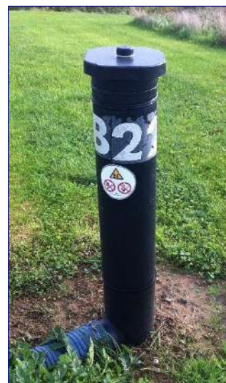
Figure 29 : Puits de biogaz et sa signalisation ATEX
